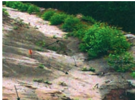
Figura 4.3 - Erosão laminar em solo arenoso. (Fonte: Weill & Pires Neto, 2007).
