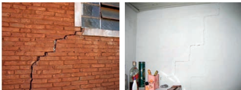
Figura 6.1 - Ocorrências de trincas e fissuras nas edificações causadas por colapsos de solo (Fontes: Rodrigues, 2007 e Acervo IG-SMA, 2009).
