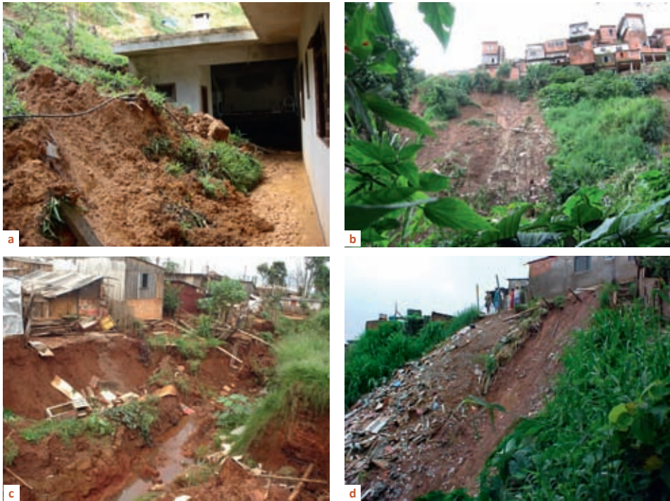
Figura 2.12 - Exemplos de situações que devem ser evitadas: (a) construção de moradias muito próximas ao talude de corte em Jaraguá do Sul, SC, 2008; (b) moradias na crista de talude com altura e inclinação excessiva em Osasco, 2006; (c) construção em margens de córregos em Itapeva, 2007; (d) lançamento e acúmulo de lixo no talude ou encosta em São Bernardo, 2005. Fonte: Acervo IG.
